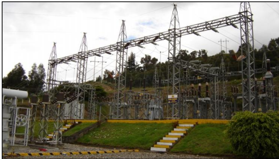
Figura 2.2 Estructura del patio 69Kv
