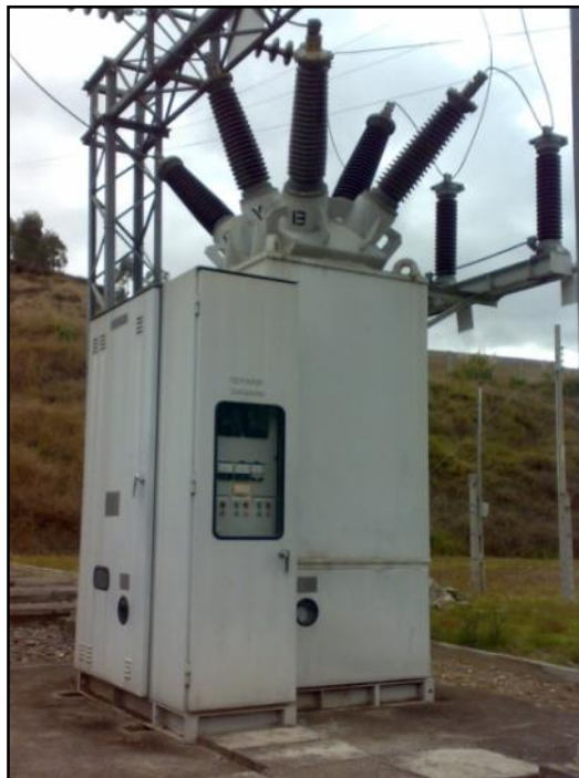
Figura 2.6 GIS de la Subestación Obrapia
