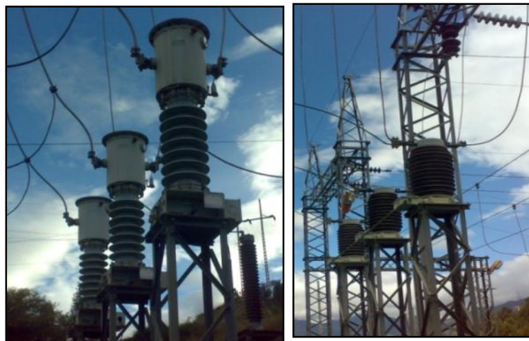
Figura 2.12 TCs de la Subestación Obrapía y su símbolo eléctrico
