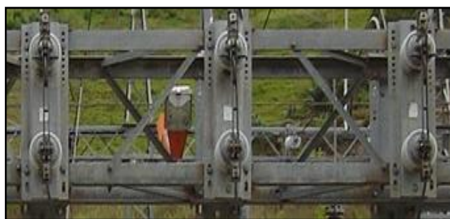
Figura 2.17 Seccionadores tipo barra del patio 13.8KV
