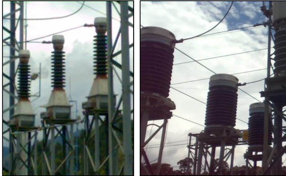
Figura 2.13 TPs de la Subestación Obrapía y su símbolo eléctrico
