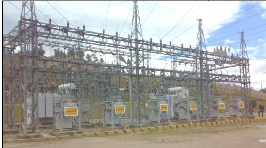
Figura 2.15 Estructura del patio 13,8 Kv
