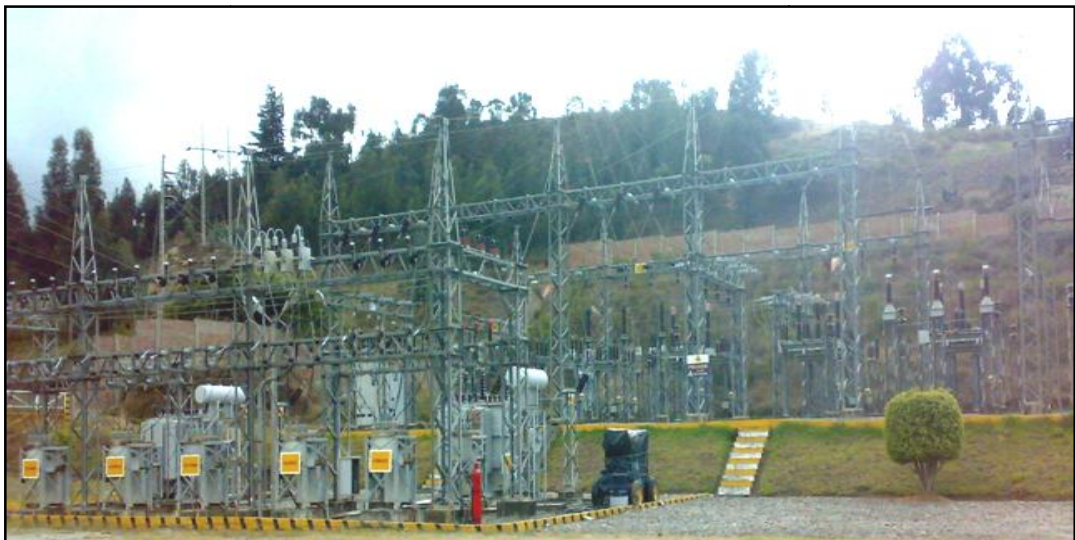
Figura 2.1 Subestación Eléctrica Obrapía de Loja
