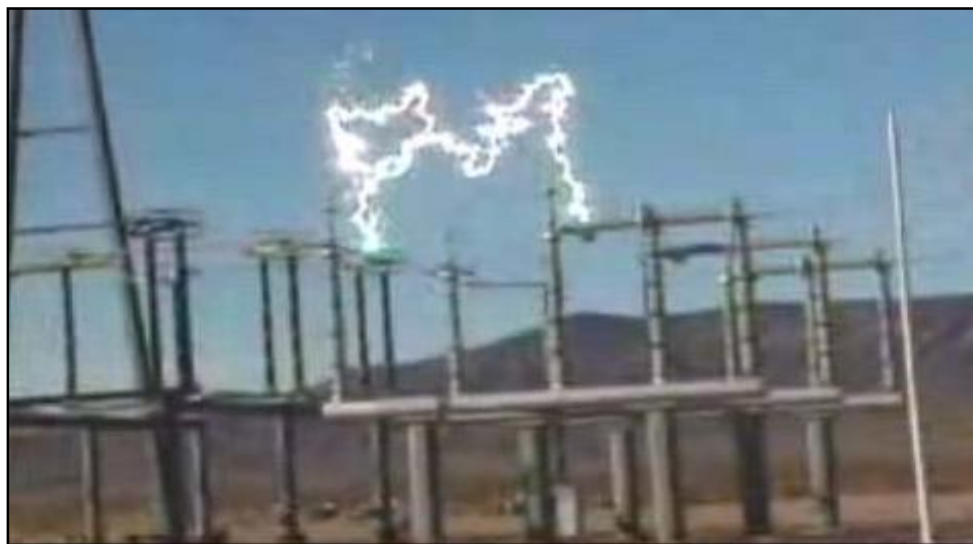
Figura2.21 Arco eléctrico en los seccionadores de potencia
