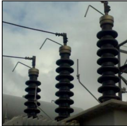
Figura 2.4 Descargador Valvular con aislante el aire
