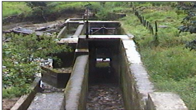
Fotografía 2 Canal de conducción, con vertedero y rejilla
