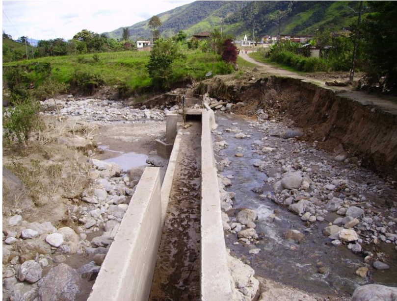
Fotografía 18 Obras de captación desripiador destruido con sedimentación
