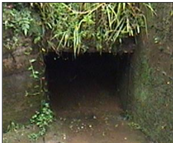
Fotografía 8 Obras de conducción canal a la salida del desarenador.
