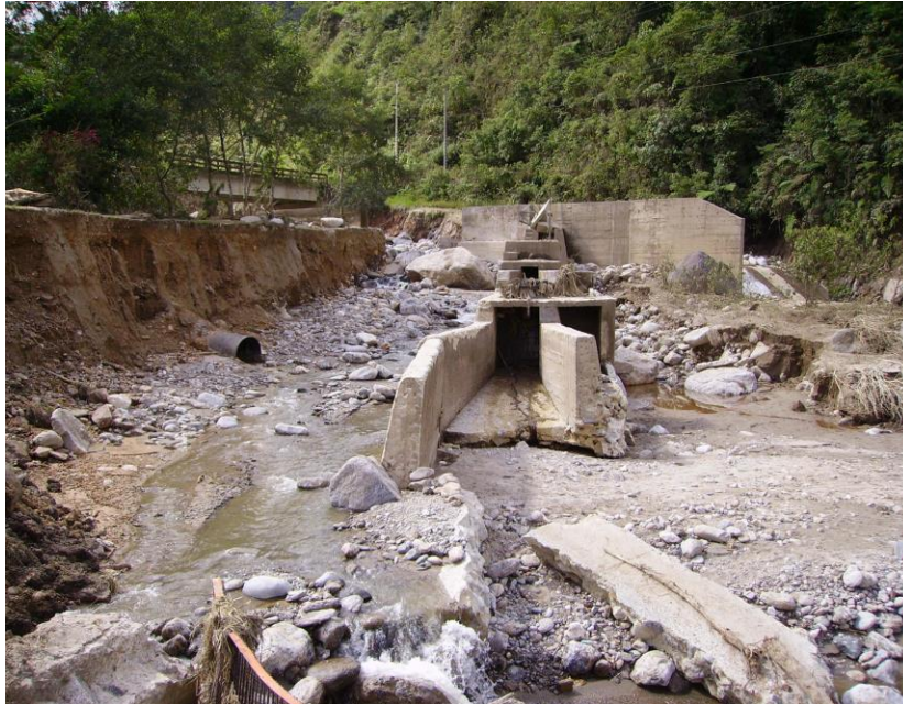
Fotografía 19 Desarenador totalmente destruido
