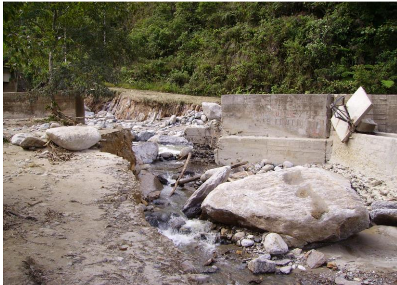
Fotografía 17 Obras de captación Azud y compuertas destruidas
