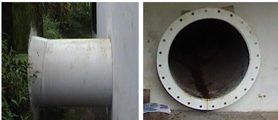
Fotografía 14 Obras de conducción Tubería de presión a la llegada a la casa de máquinas.
