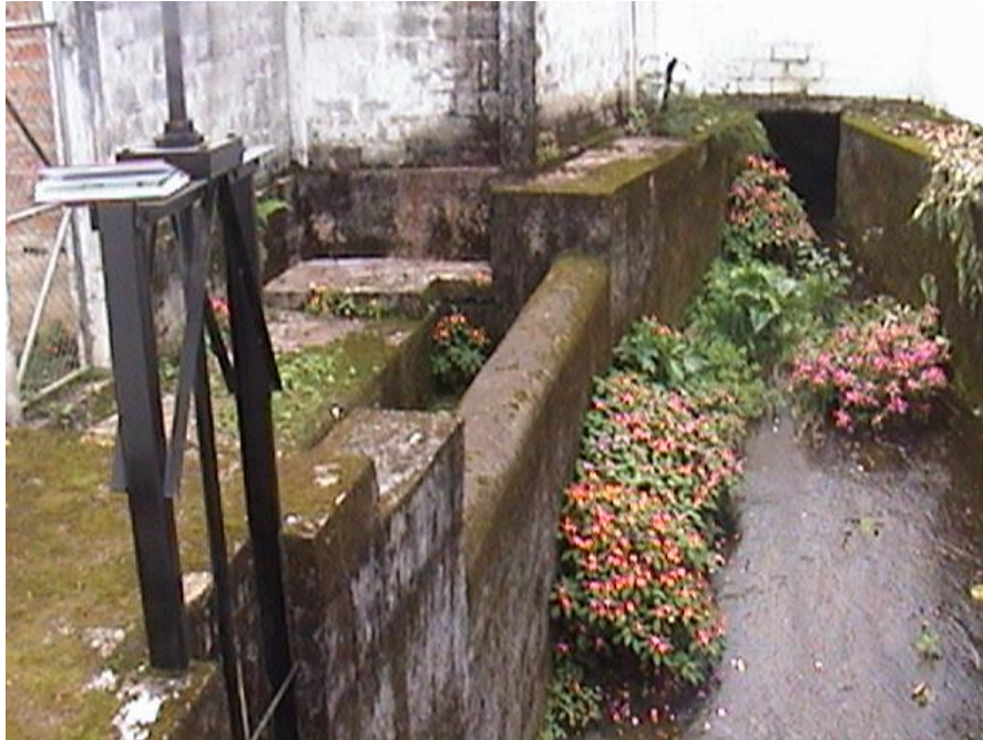
Fotografía 20 Tanque de presión situación actual
