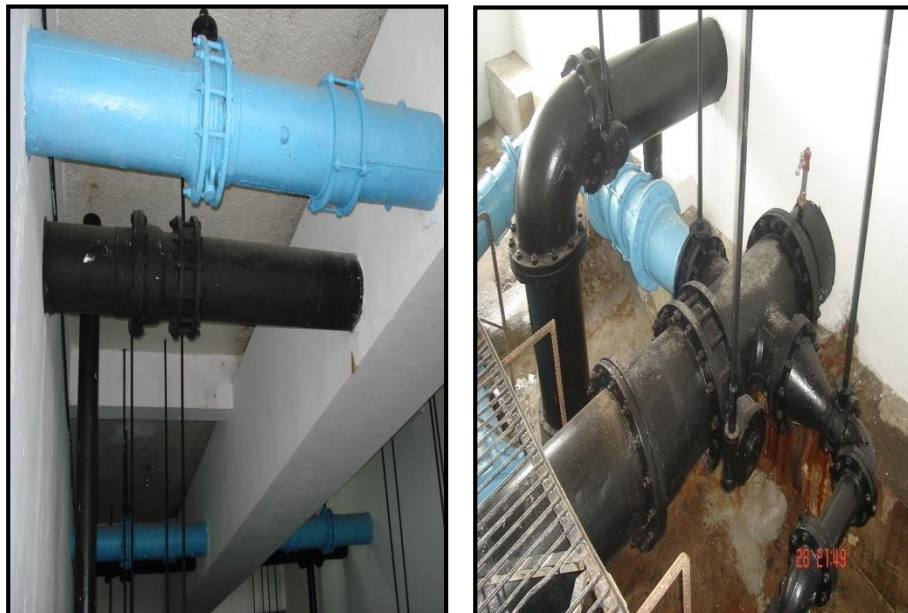
Fig. 1.7 y 1.8 Accesorios y tuberías de los filtros de la planta PUCARA.
