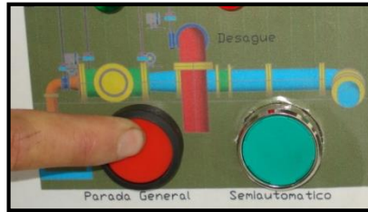
Fig. 5 Parada de emergencia.
