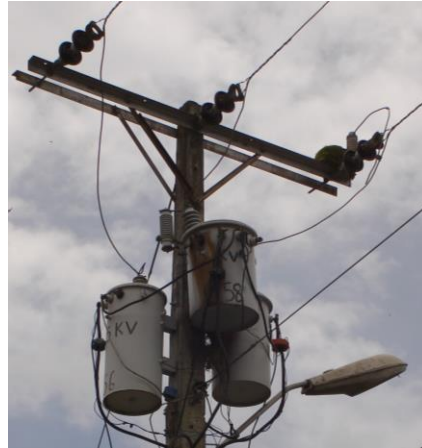
Figura 2.11 Bancos trifásico conformados por tres transformadores monofásicos.
