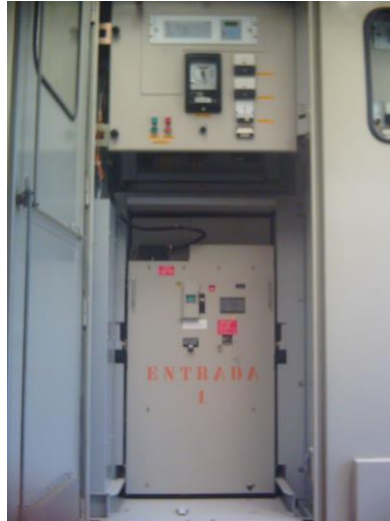
Figura 2.4 Relé DPU2000R junto a un interruptor extraíble.
