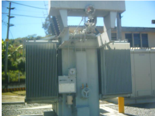
Figura 2.2 Transformador de 10MVA de la subestación San Cayetano.
