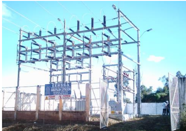
Fotografía 1. Subestación Catacocha (1 MVA – 69/13,8 kV).
