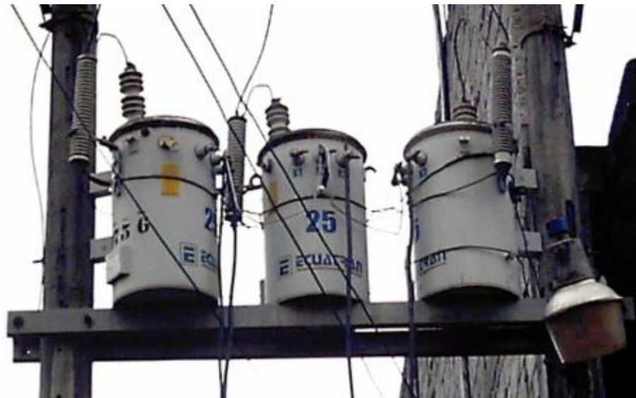
Fotografía 2. Banco de transformadores 3x25 kVA (Gualaquiza).
