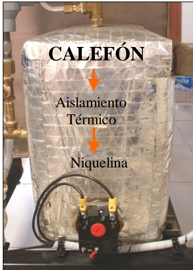
Fig. 4.5 Calefón Eléctrico y Regulador de Temperatura
