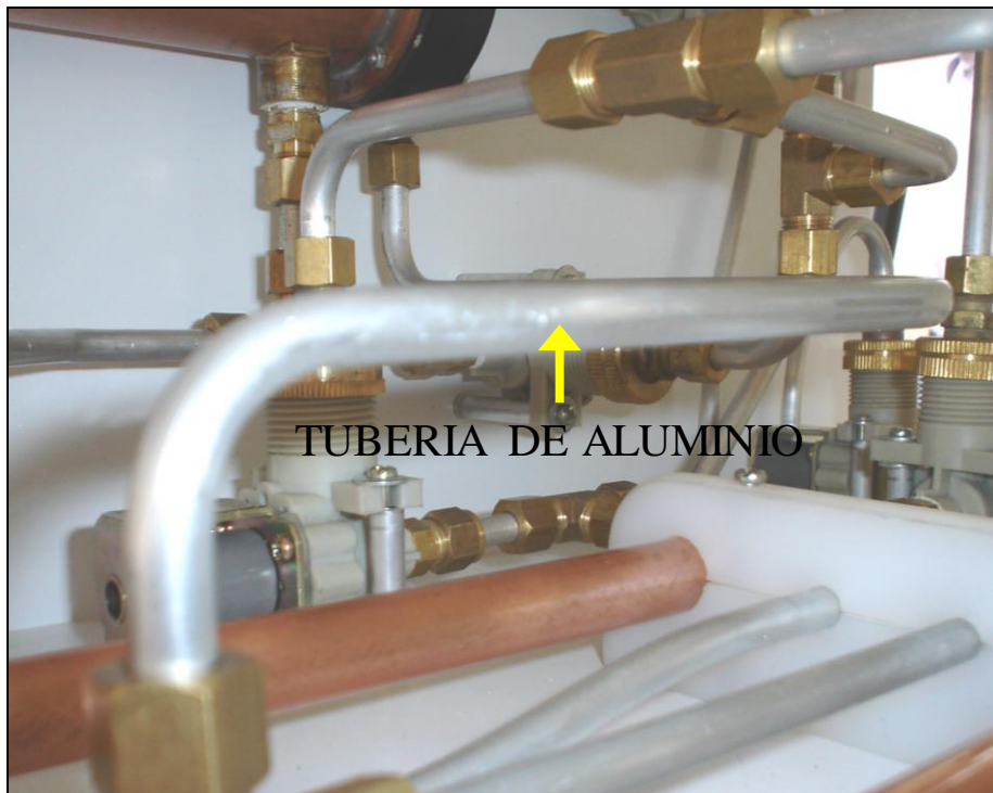
Fig. 4.7 Tuberías de Aluminio de Fluidos Frío y Caliente
