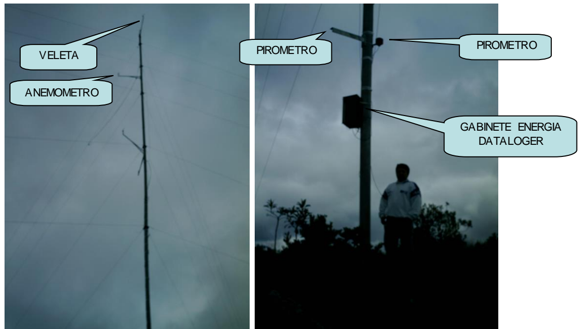
Figura 38: Estación de monitoreo Villonaco HCPL
