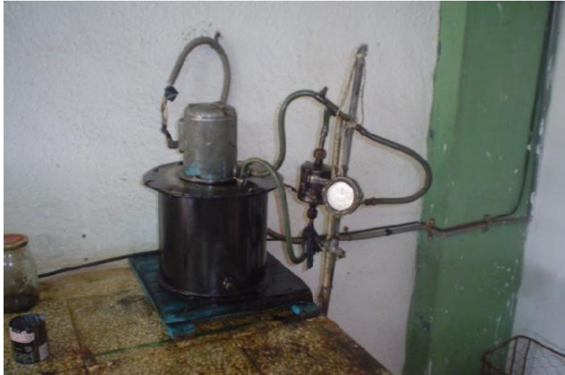
Instalación piloto armada
