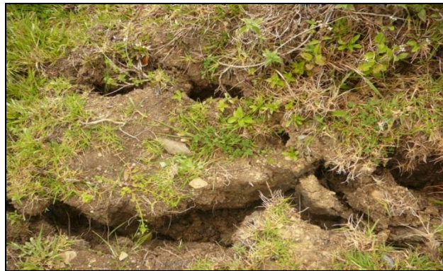
Foto 9. Abertura deslizamiento N° 2
