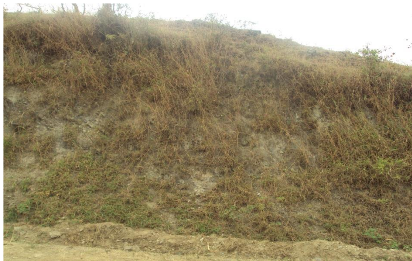
Figura N° 17. Corte del talud por vía se evidencia el tipo y la potencia de los suelos .
