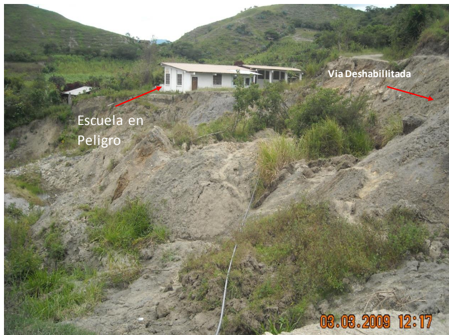
Figura N° 23 Infraestructuras en peligro.
