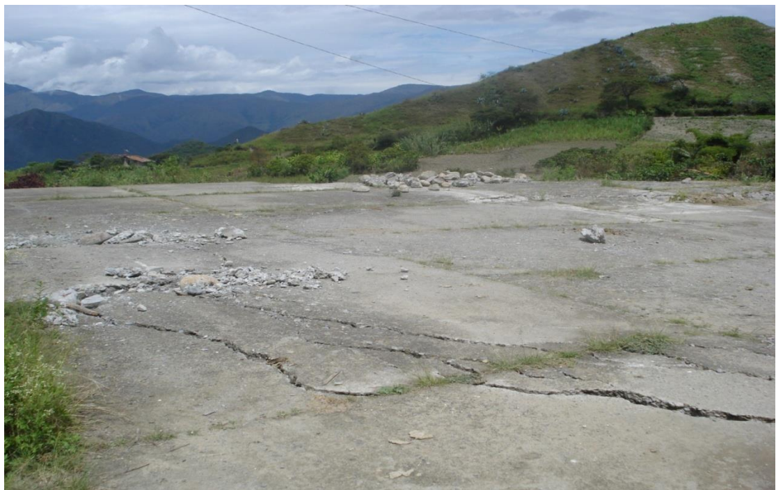
CANCHA DEPORTIVA ANTES DE COLAPSAR POR ACCIÓN DEL DESLIZAMIENTO. MAYO 22 – 2008
