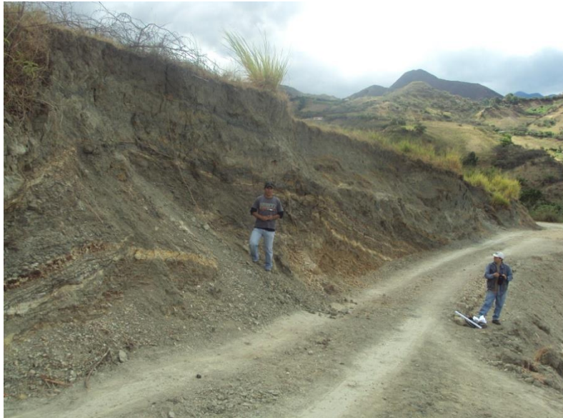
Figura N° 16. Corte del talud por vía se evidencia el tipo y la potencia de los suelos .
