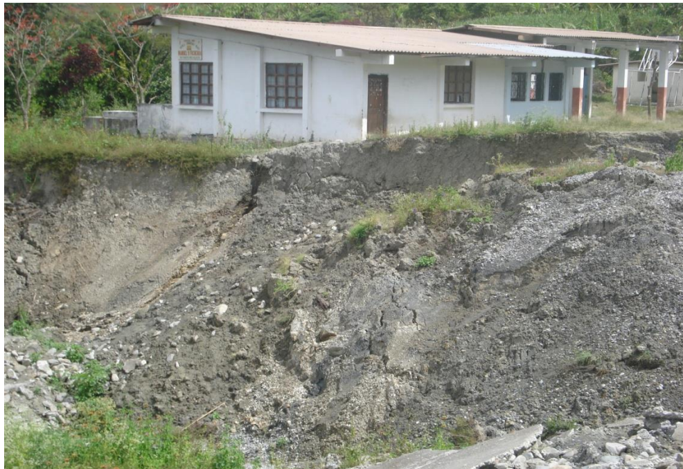
EN PELIGRO EVIDENTE LA ESCUELA MANUEL FIGUEROA CARRIÓN UBICADA EN LA CORONA DEL DESLIZAMIENTO
