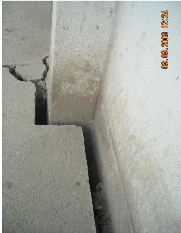
GRIETAS EN LA INFRAESTRUCTURA DE ESCUELA POR EFECTOS DEL DESLIZAMIENTO. MARZO 03 – 2009.
