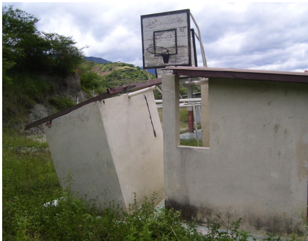
INESTABILIDAD Y DAÑOS A LA INFRAESTRUCTURA DE LA ESCUELA “MANUEL FIGUEROA CARRIÓN”
