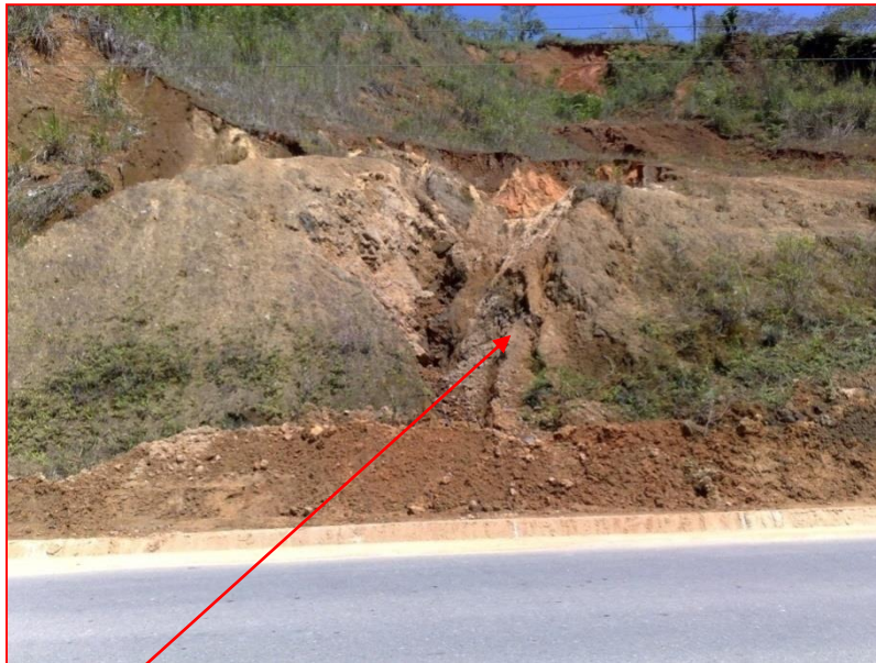
Foto Nro. 06"Deslizamiento 04"
