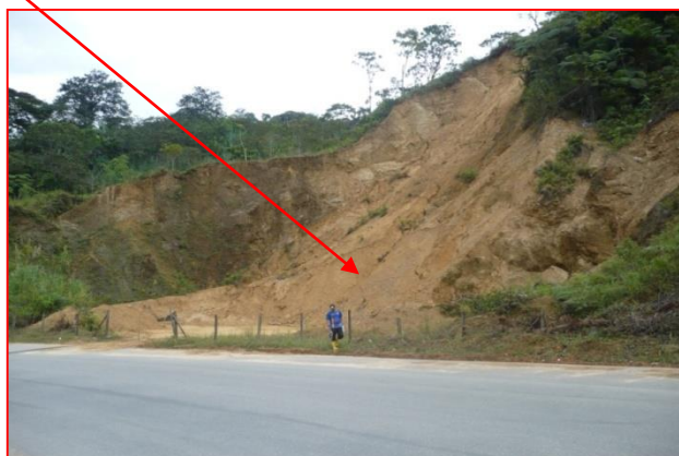
Foto Nro. 05”Deslizamiento 03”
