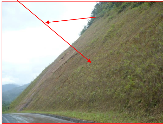
Foto Nro. 02"Deslizamiento 05"
