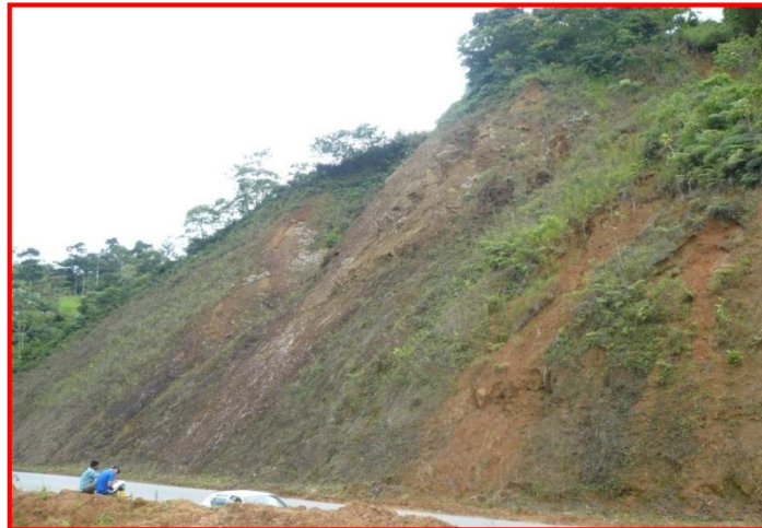
Foto Nro. 04”Deslizamiento 02”
