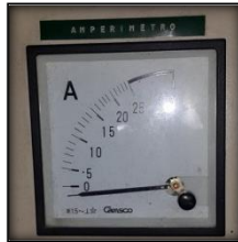
FIG 53. Amperímetro Fuente: El autor
