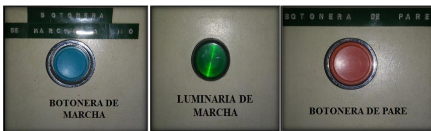
FIG 49. Botonera de Marcha y Pare, Luminaria de Marcha Fuente: El Autor
