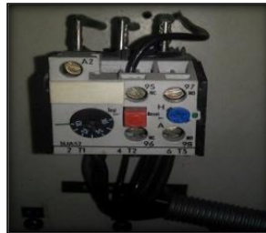
FIG 48. Relé Térmico Fuente: El autor
