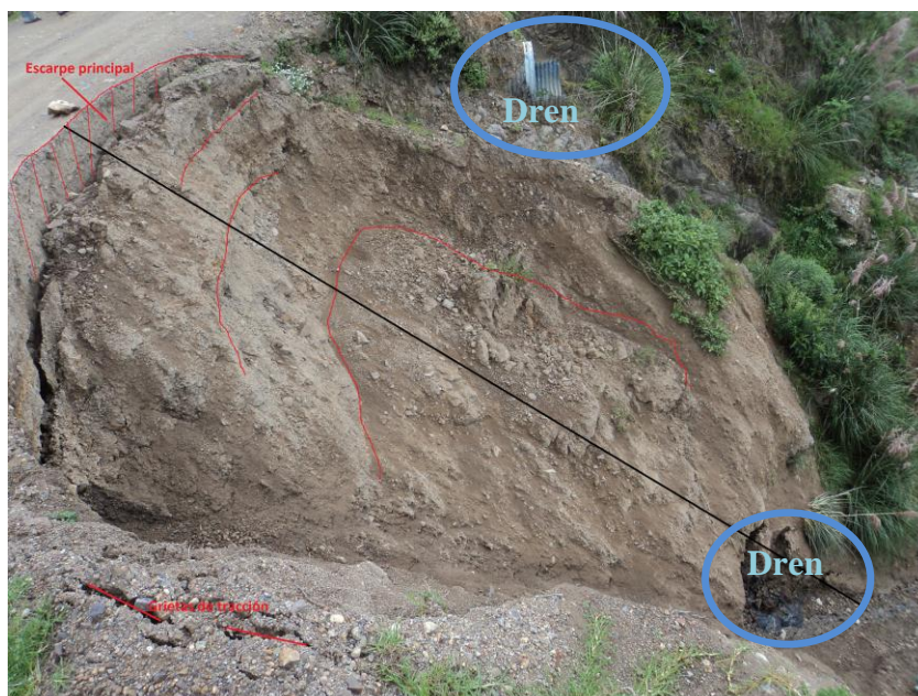
Fotografía 21. Deslizamiento en el Barrio Bahín.
