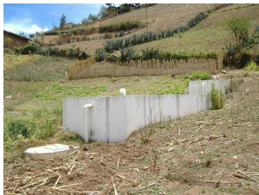
Fotografía 14. Tanques de recolección de aguas residuales.
