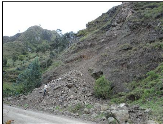
Foto 48. Deslizamiento 3 Sitio: Parroquia Chantaco Fecha: Noviembre de 2011 Coordenadas: 685860; 9569931; 2081
