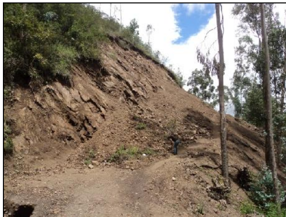
Foto 59. Vías en mal estado Sitio: Parroquia Chantaco Fecha: Noviembre de 2011 Coordenadas: 685489; 9570639; 2241
