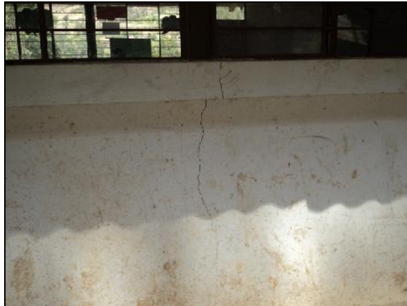
Foto 46. Daños en infraestructura Sitio: Parroquia Chantaco Fecha: Noviembre de 2011 Coordenadas: 685842; 9570645; 2248
