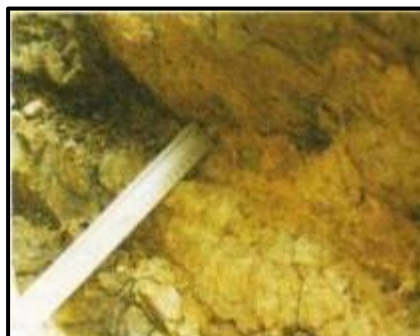
Fotografía 7. Discontinuidad ondulada rugosa en calizas con abertura muy ancha y relleno arcillosos.
