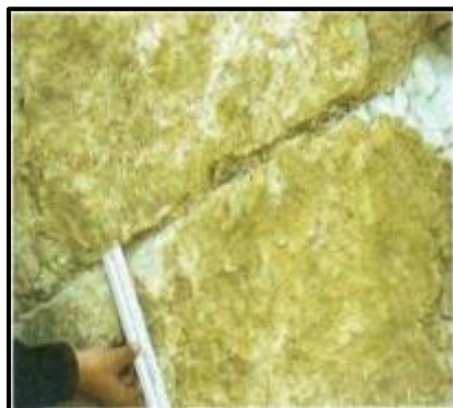
Fotografía 6. Discontinuidad plana rugosa con abertura ancha y relleno arcillosos seco.
