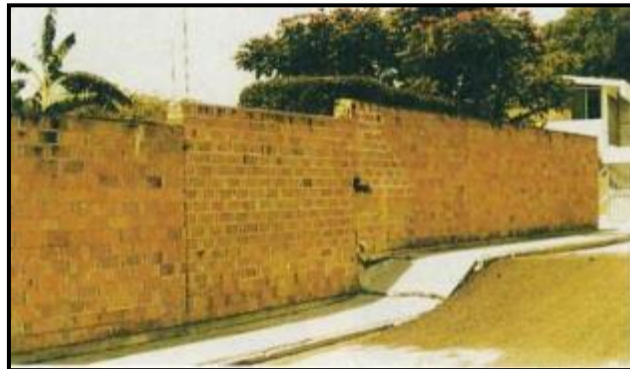
Fotografía 2.- Subsistencia por extracción de agua de pozos y a favor de fallas activas (Celaya, Méjico)
