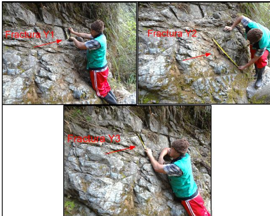
Fotografía 25. Fracturas en el eje Y.
