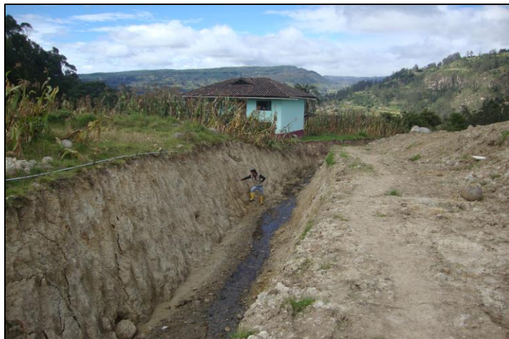
Figura 48. Zanja N° 3 de material limoso en el flanco Este de la comunidad Las Lagunas.
