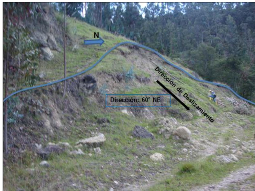
Figura 29. Deslizamiento N° 1 localizado dentro del coluvión.
