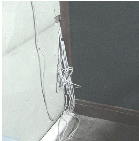
Imagen 2.3. Canalización en el AEIRNNR
