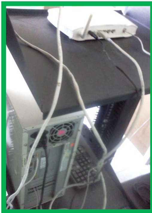
Conexión del Servidor a la Línea Telefónica
