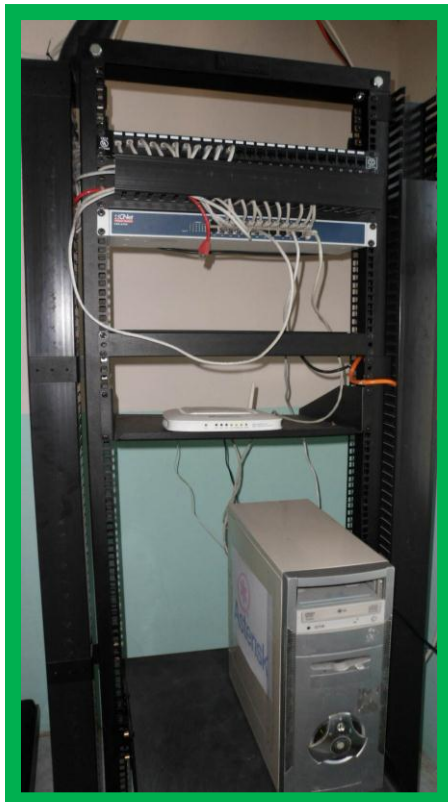
Ubicación del Servidor para la conexión a la red
