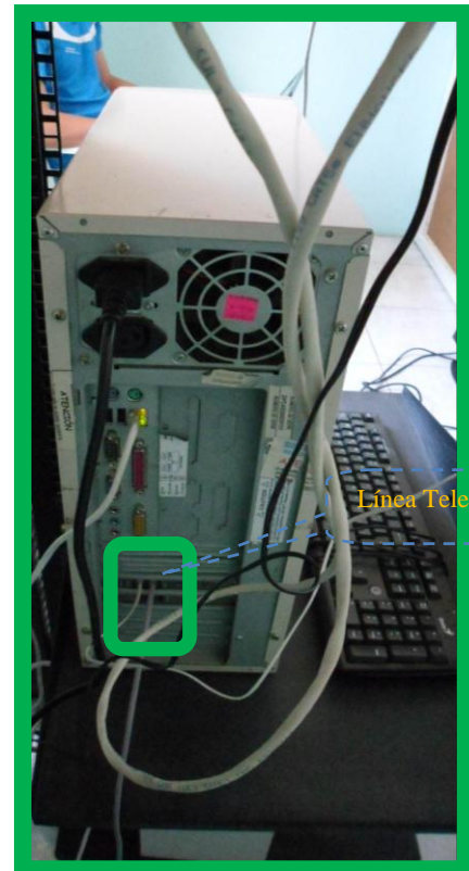
Conexión del Servidor a la red de datos y línea telefónica
