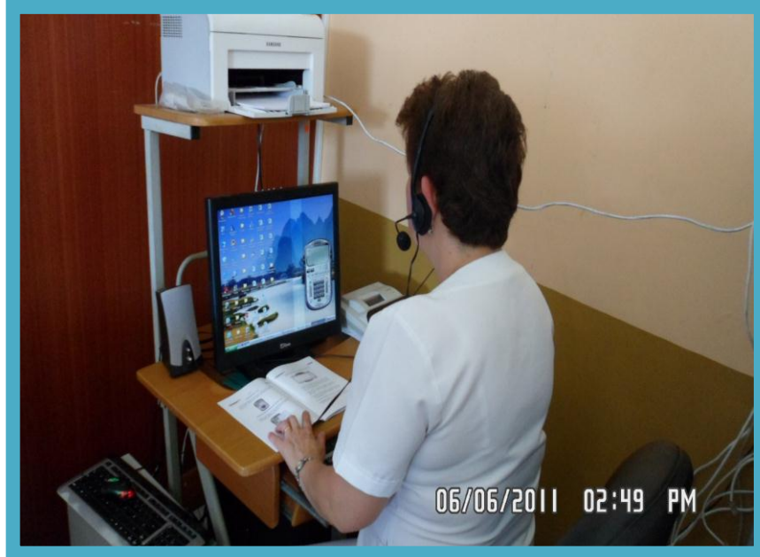
Instalación del Softphone X-Lite en el departamento de Servicios Institucionales equipo 2
