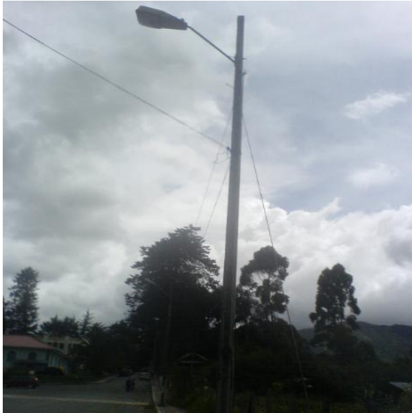
Figura 95. Área Energía (poste)
