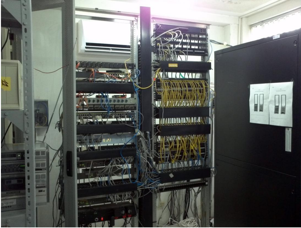
Figura 62. Equipos del Networking principales en el cuarto de telecomunicaciones de la UTI.
