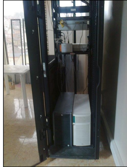
Figura 24: Data Center INPC R7
