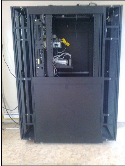
Figura 23: Data Center INPC R7 vista lateral
