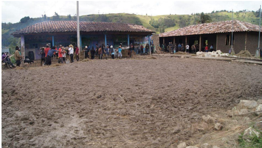
(Fig. 2): Minga construcción de la casa comunal de Chukidel Ayllu Llakta (Las Lagunas). Quizhpe, D. (2013) La minga . [Fotografía].
