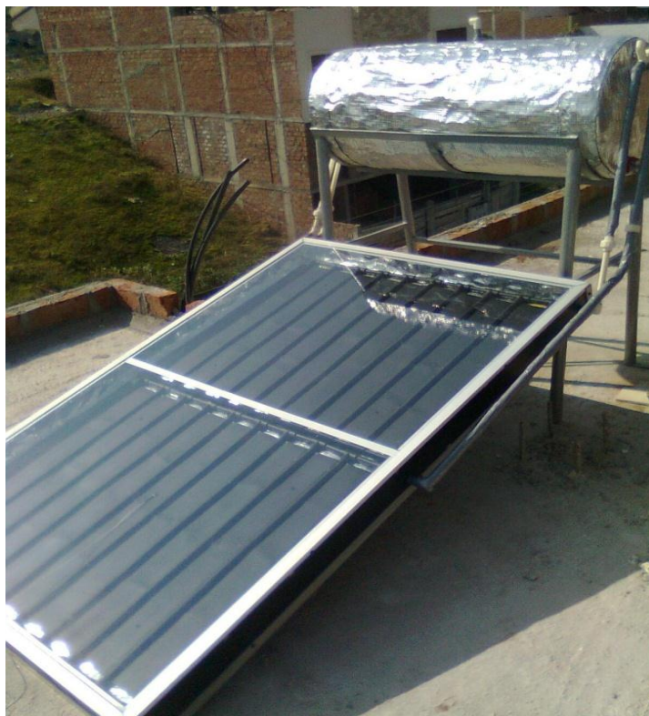
Fig. 36. Calentador de agua instalado listo para usar
