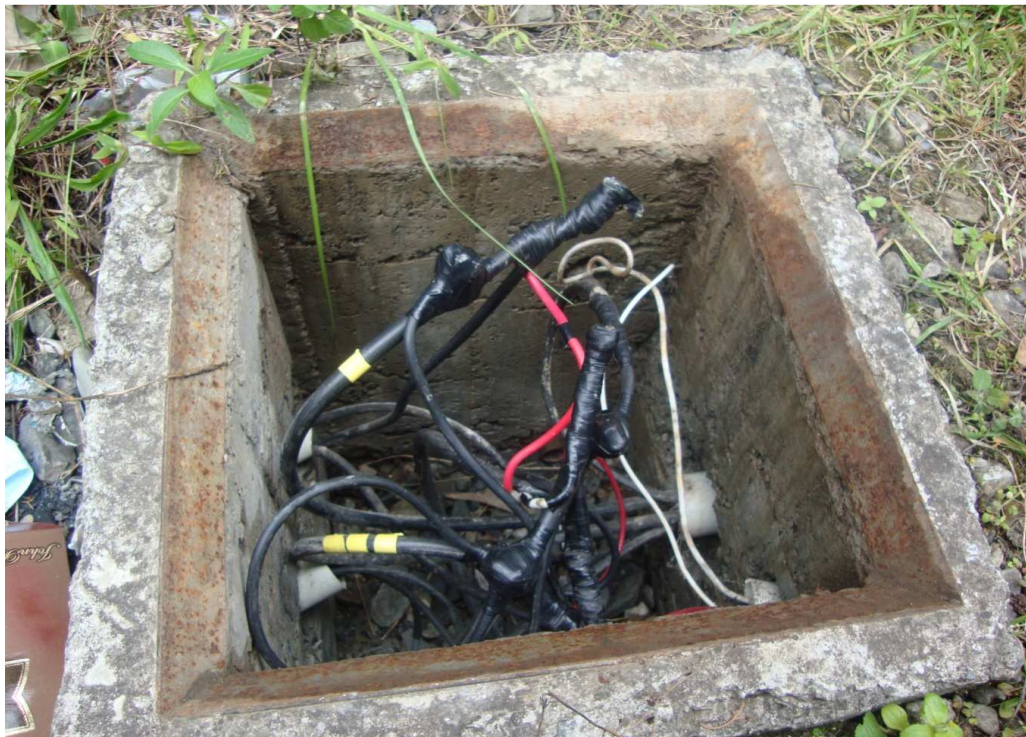
Pozo de acometidas bloque 5
