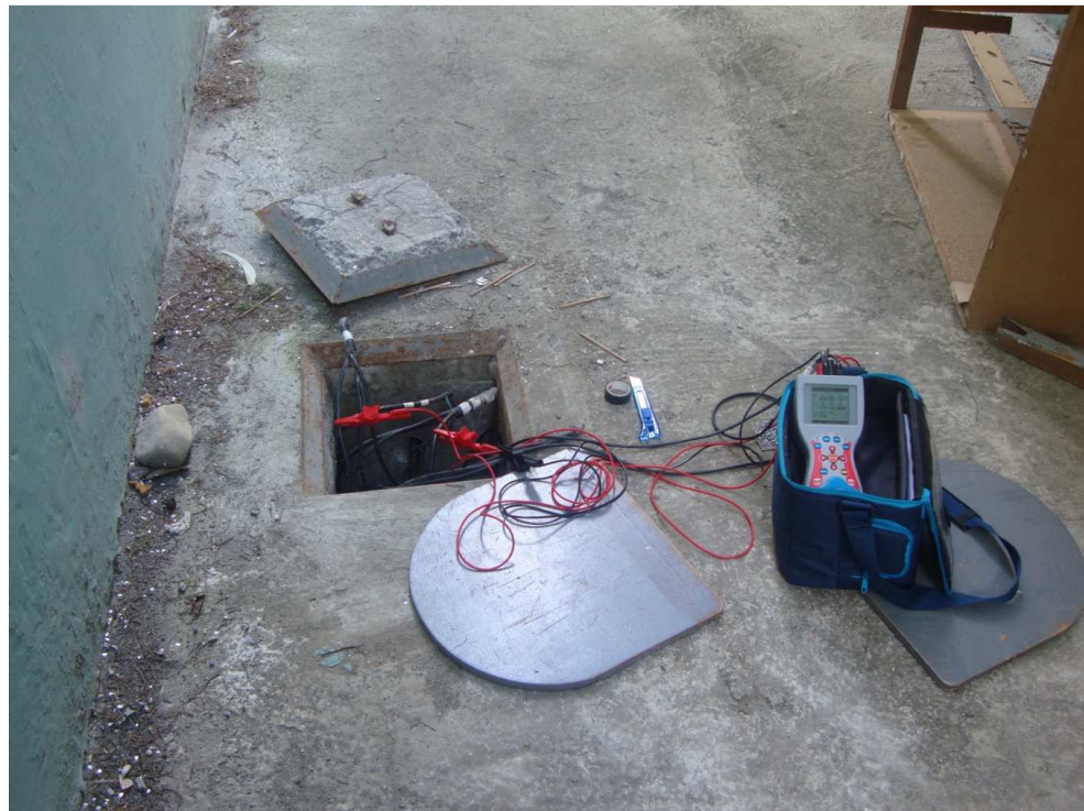
Mediciones con metrel registrador de potencia en el bloque 5
