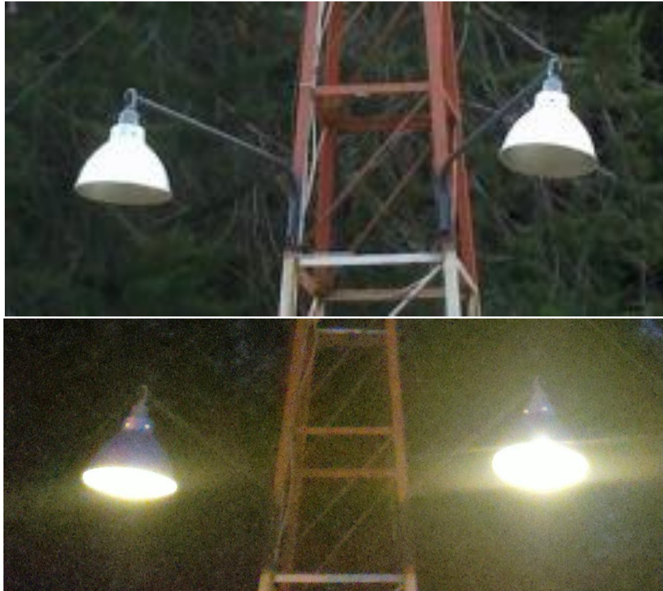
Figura 61. Luminarias y protecciones
