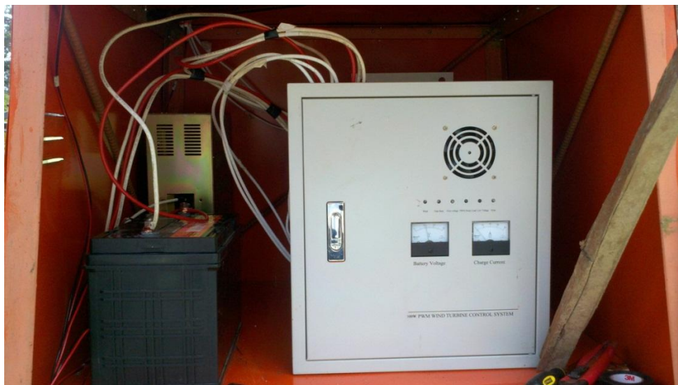
Fotografía 3. Equipo de control
