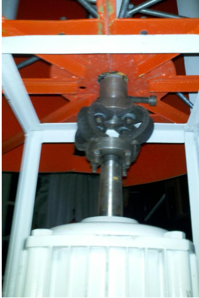
Figura 57. Brida de transmisión armada y fijada al eje del generador y del rotor.
