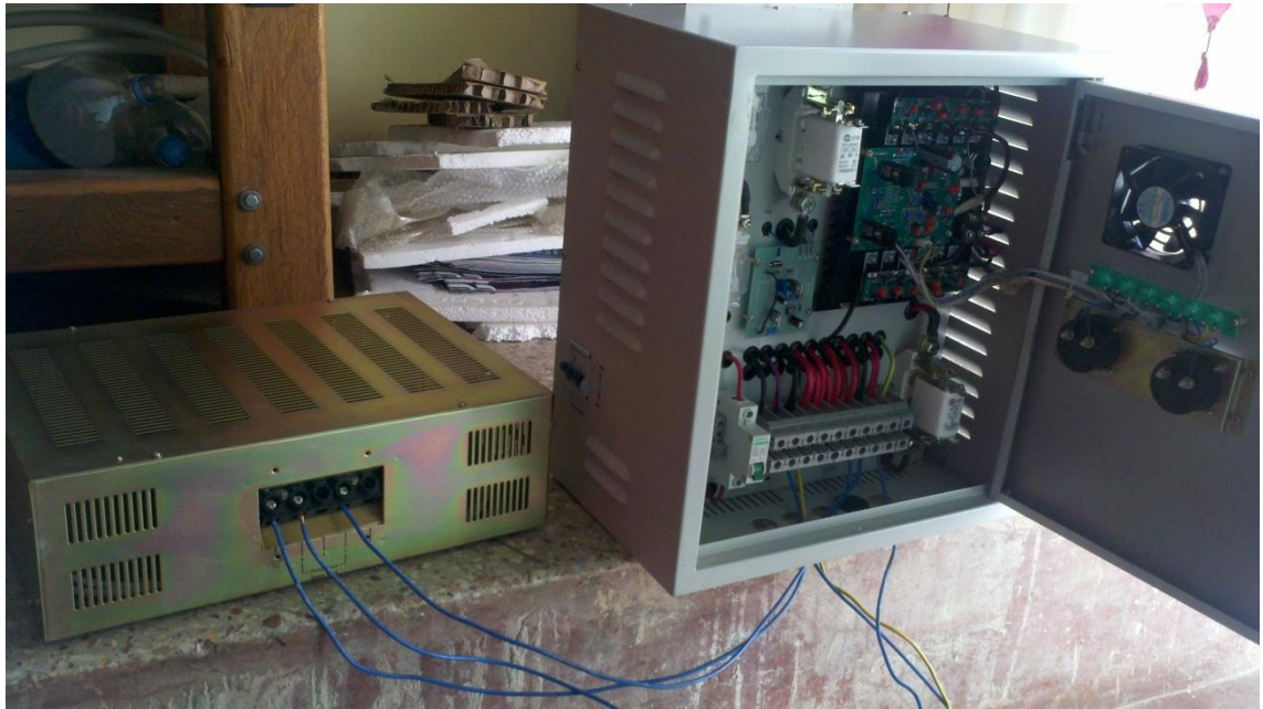
Figura 42. Equipo inversor controlador y banco de resistencia marca EXMORK
