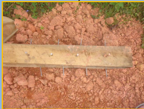
Columna de madera con clavos para lograr una mayor seguridad al ser fundida
