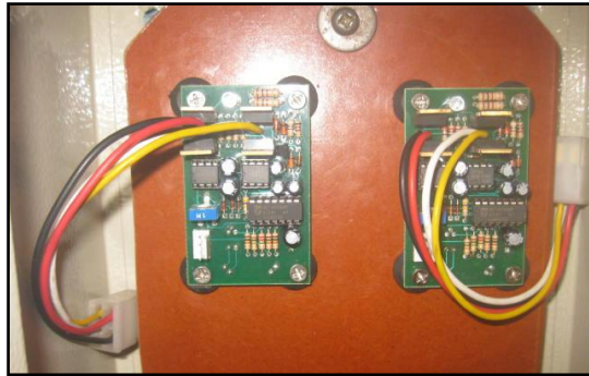
Fig. 107. Placas de control.
