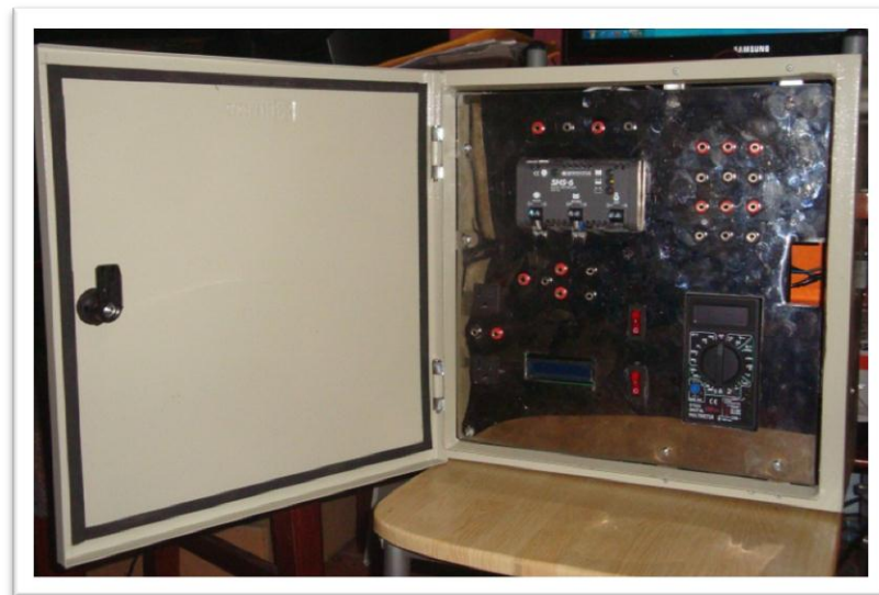
Figura 3.24: Caja de Control vista externa.
