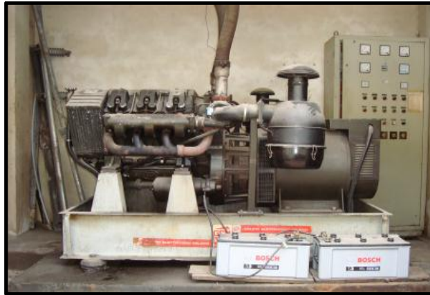
Figura 18. Generador Auxiliar de 125 KVA
