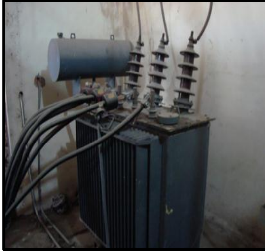
Figura 13. Transformador de 300 KVA existente en el hospital
