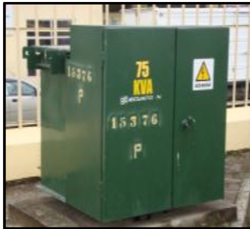
Figura 16. Transformador Padmounted de 75 KVA
