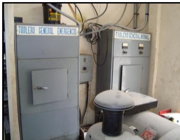
Figura 19. Tableros generales de distribución de energía eléctrica
