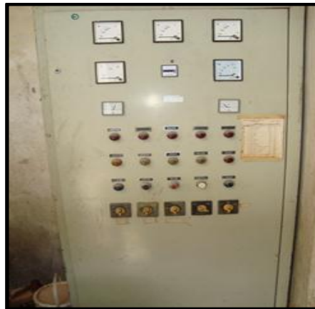
Figura 20. Tablero de transferencia automática
