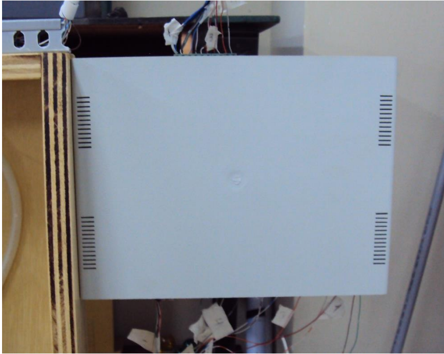
Figura 23. Foto de la parte externa de la caja de circuitos (Autor)
