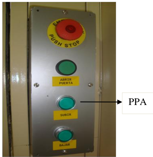
Figura 38. Panel de maniobras
