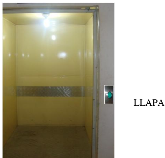
Figura 43. Pulsador de llamado automático en planta alta
