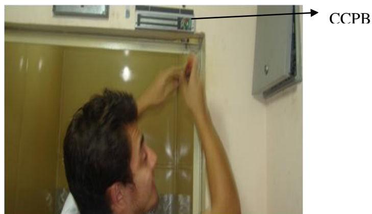
Figura 45. Contactos de la cerradura instalada en la puerta de planta baja
