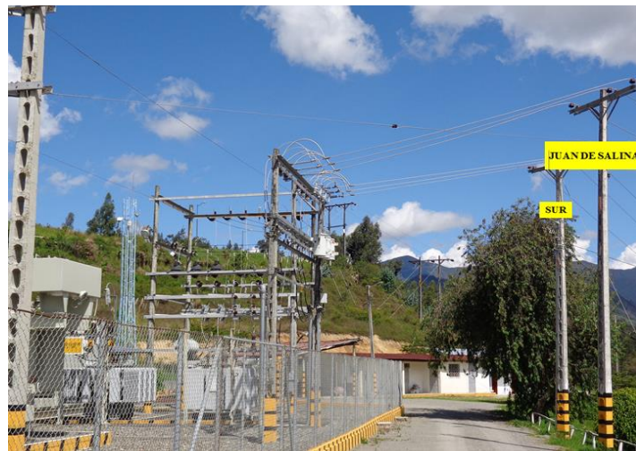
Figura 1. Subestación Eléctrica San Cayetano EERSSA
