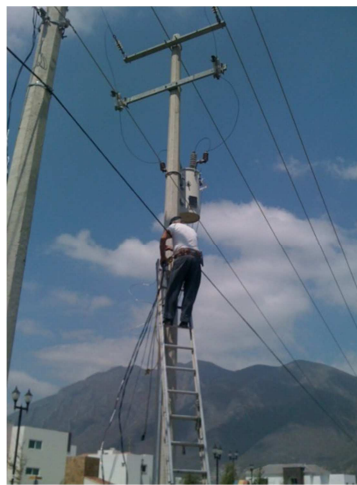
Figura 3. Red Eléctrica de MT y BT.
