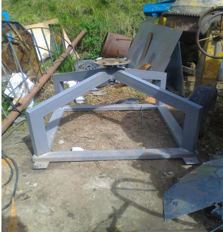
Figura 35. Base del aerogenerador.
