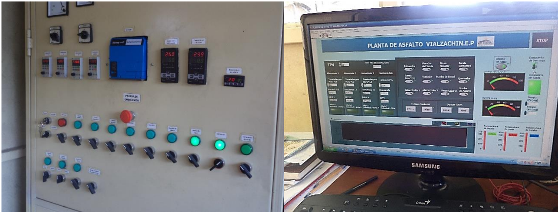
Figura 25 y 26: Panel y pantalla de control
