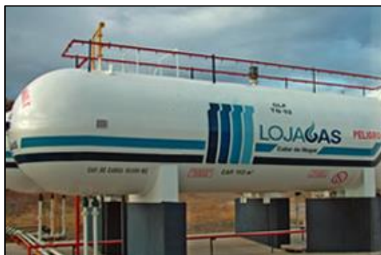
FIGURA 1: Tanques estacionarios para almacenamiento de GLP
