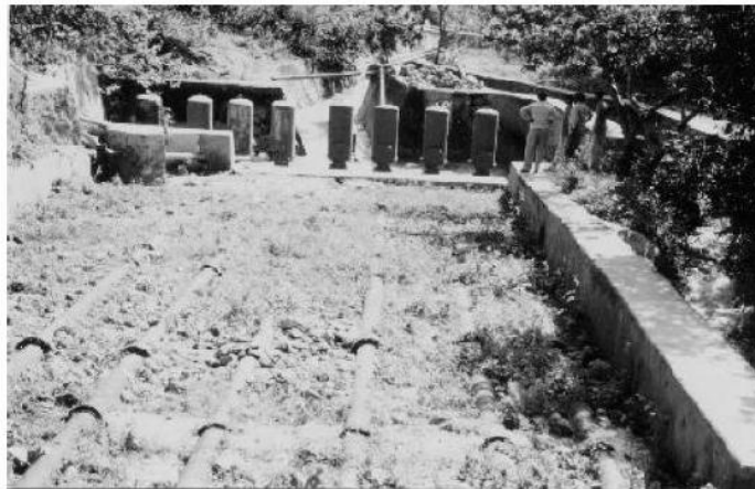
Fig. 22 Ocho Arietes hidráulicos instalados en serie
