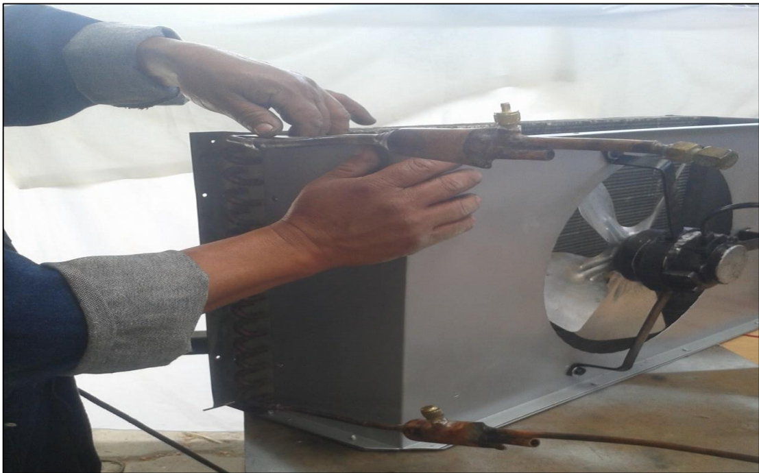
Foto 04: Unión del serpentín a la carcasa del condensador.
