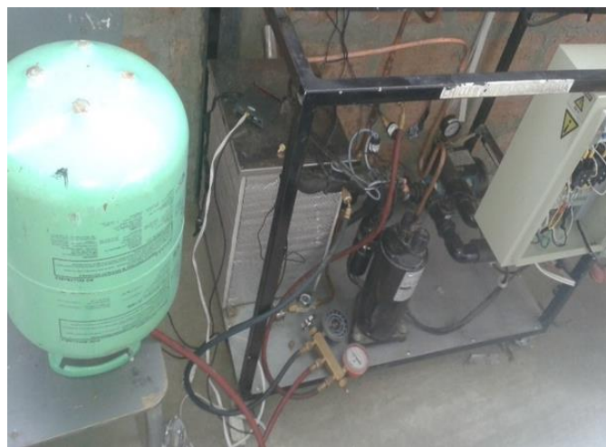
Fig. 41: Carga del refrigerante en el sistema.
