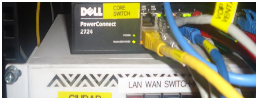
Figura 38. Switch principal de la red interna.
