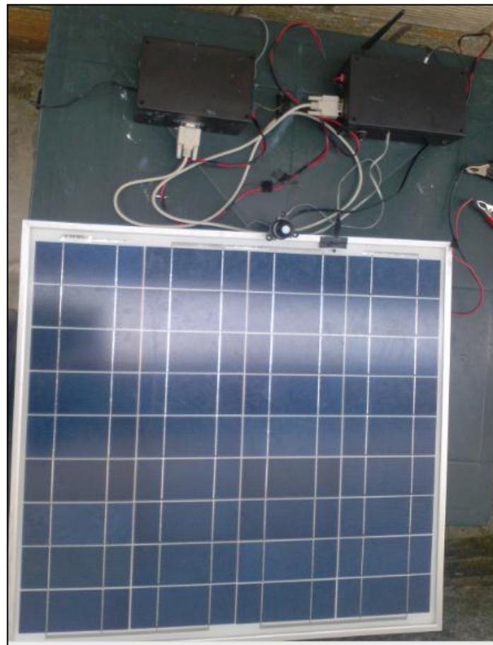
Figura 39. Conexión entre el prototipo caracterizador y el panel fotovoltaico.
