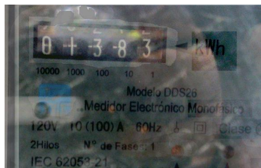
Figura 39. Medidor de energía de la empresa eléctrica para la realización de pruebas.
