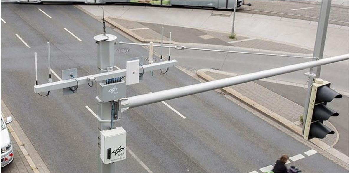
FIGURA 73. Vista de semáforos funcionando con Access Point.
