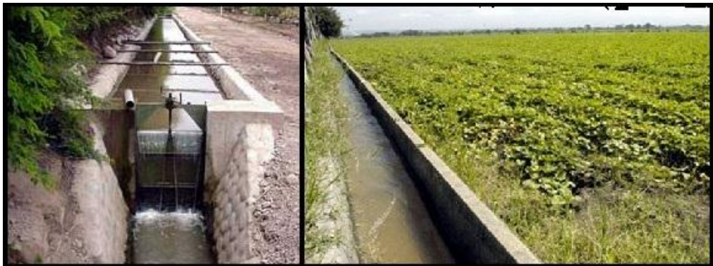
Figura 1. Canal de Riego Revestido.
