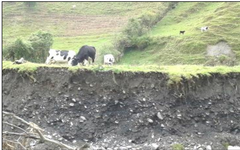
Figura 17. Erosión de las orillas en la subcuenca Zamora Huayco
