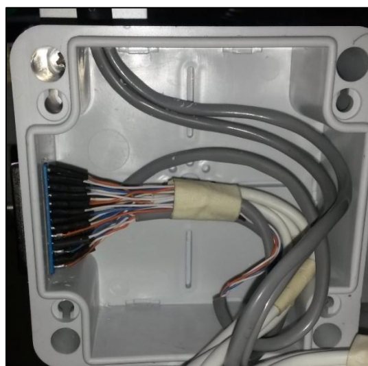
Figura 60. Cableado de los motores en la caja de paso. (Autor)
