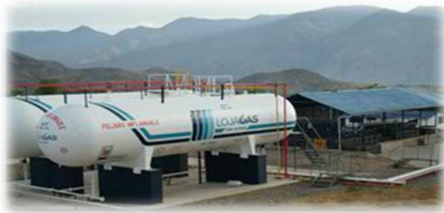
Figura 4: Planta de almacenamiento Catamayo.
