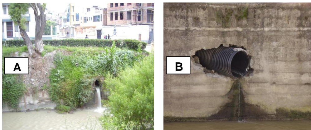
Figura 5. Fotografías: A, Descarga domésticas en la Av. Universitaria y Gonzanamá; y, B, descarga de aguas residuales al río Malacatos, Av. Universitaria y 10 de Agosto.
