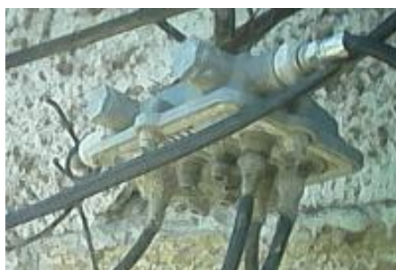
Figura. 33. Tap IKUSI utilizado en la red de distribución.
