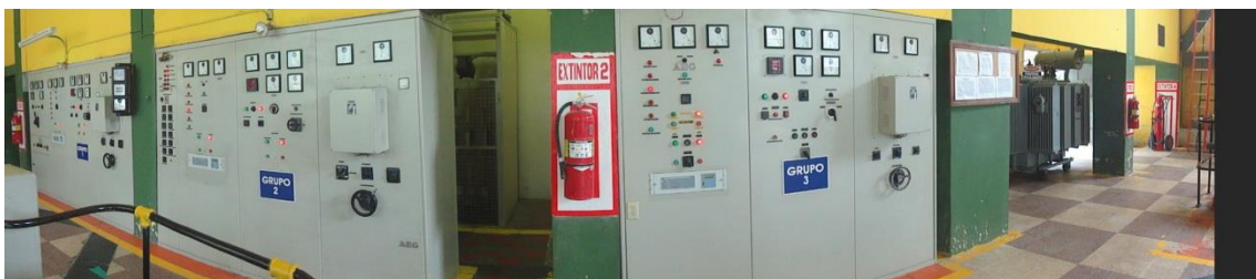
Figura 5.18. Tableros de Control de los Grupos de Turbinas
