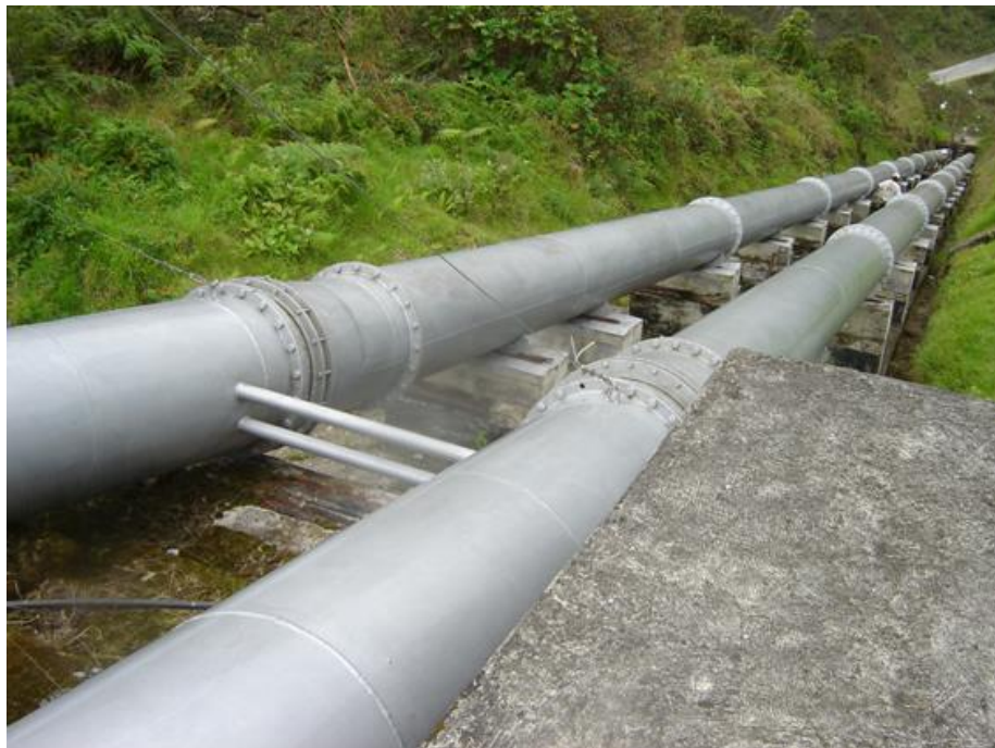
Figura 5.13. Tuberías de Presión
