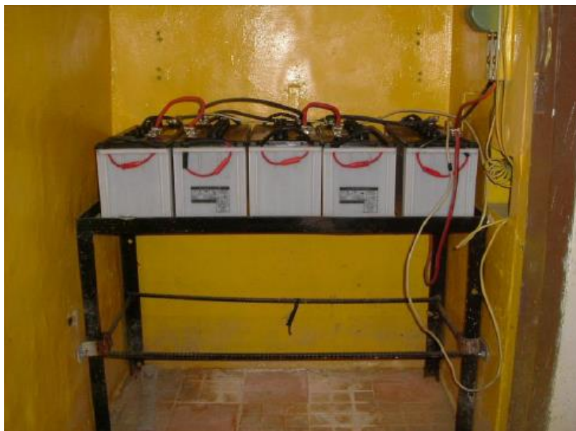
Figura 5.24. Banco de Baterías
