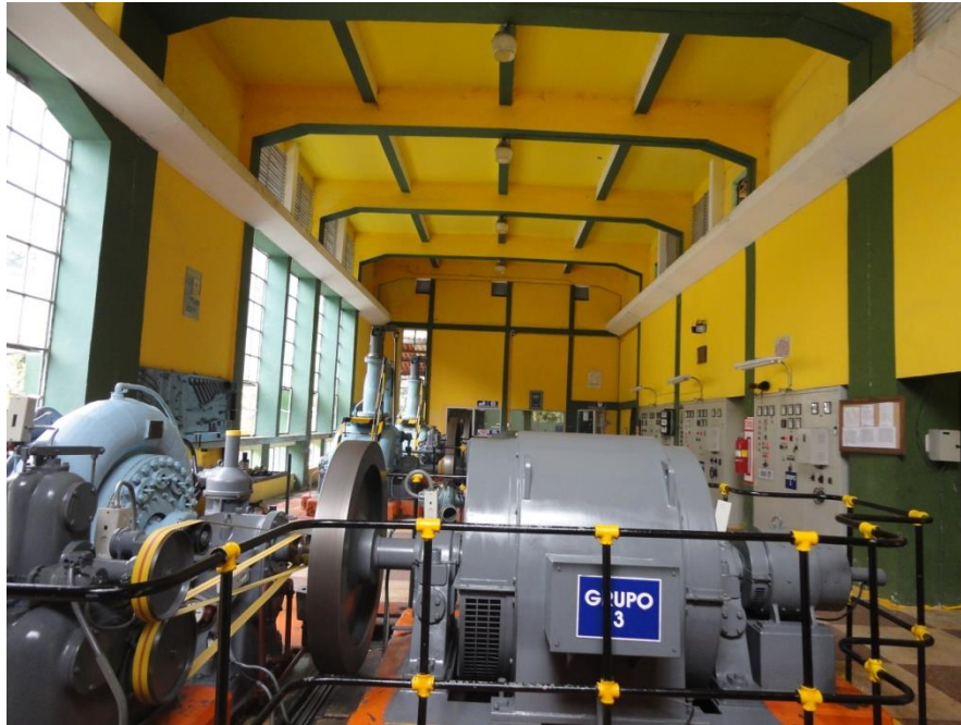
Figura 5.17. Turbina del Grupo 3
