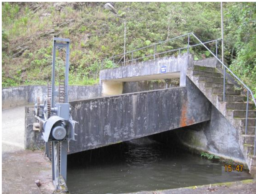
Figura 5.11. Tanques de tubería de presión de Grupos 1 y 2
