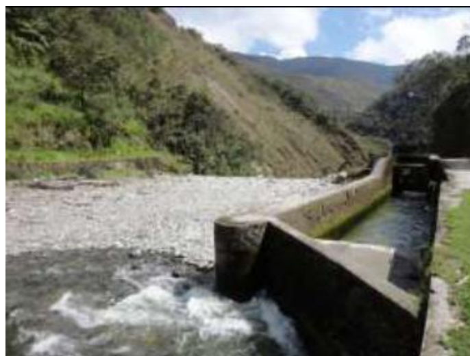
Figura 5.3. Captación del Rio San Francisco
