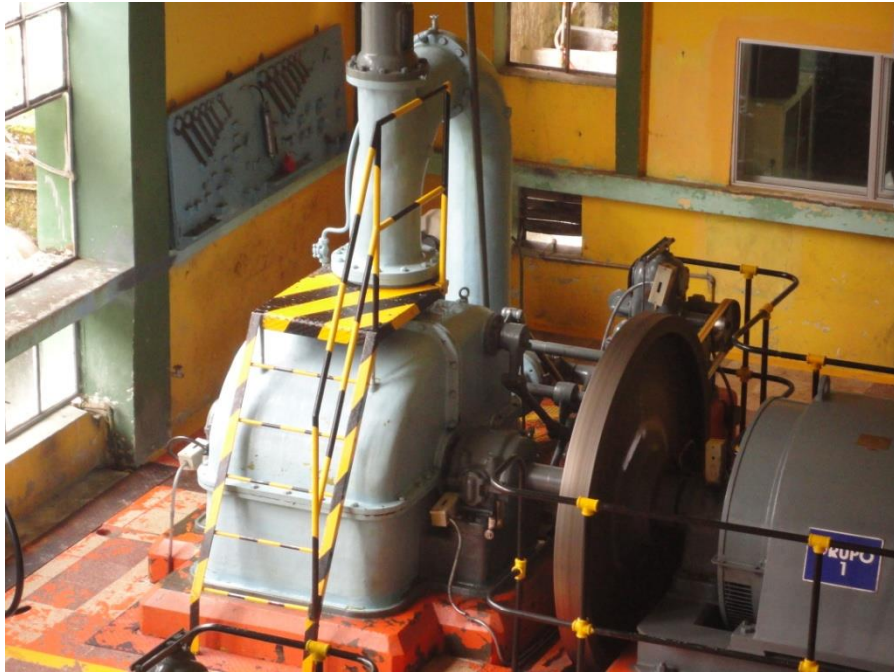
Figura 5.15. Turbina del Grupo 1
