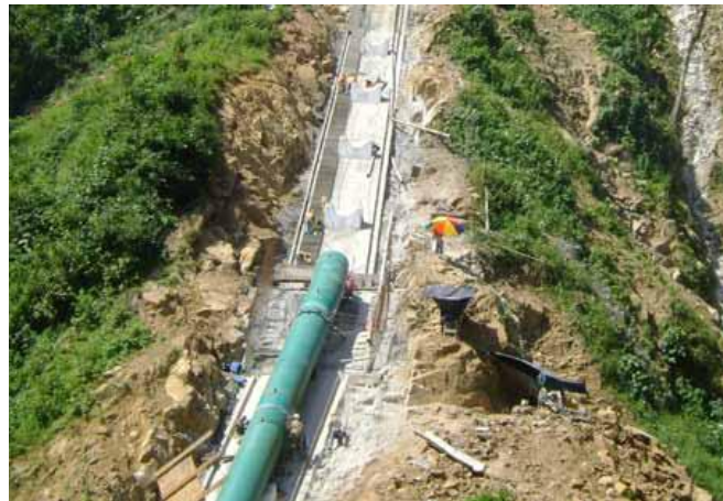
Figura 2.17. Tubería forzada de una Central Hidroeléctrica de Pasada
