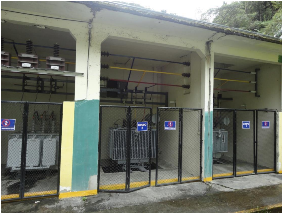
Figura 5.19. Transformadores elevadores de 2.3 KV a 22KV
