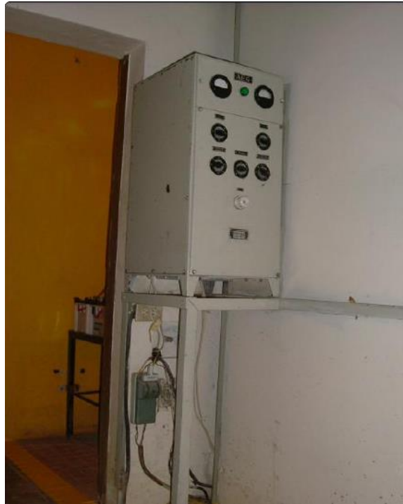
Figura 5.23. Tablero de control de Cargador de Baterías
