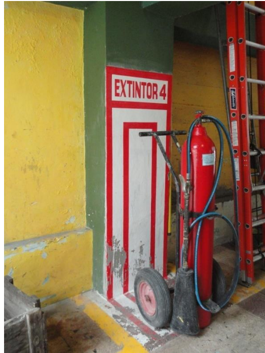
Figura 5.28. Extintores contra incendio Central Hidroeléctrica
