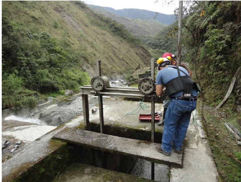
Figura 5.6. Compuerta en la captación del río San Francisco
