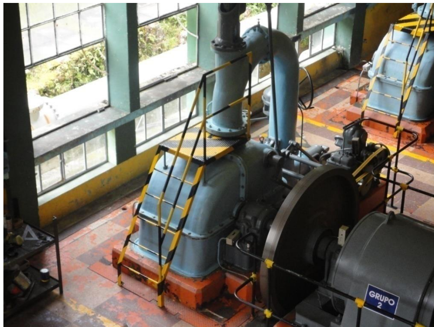
Figura 5.16. Turbina del Grupo 2
