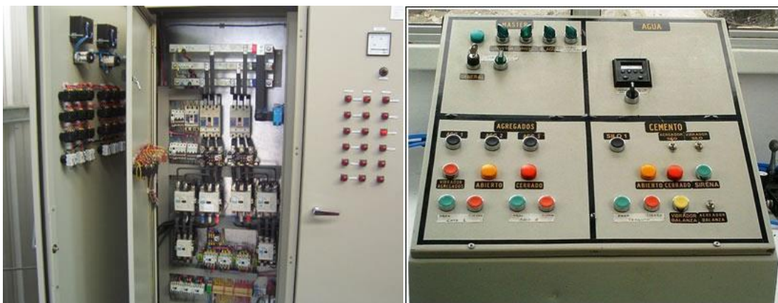
Figura 2.28. Tablero de control de una central hidroeléctrica de pasada
